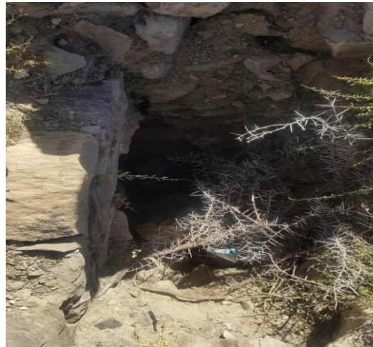
الشكل ٢١: حفرة ناتجة عن أعمال الحفر والنبش داخل المبنى في الركن الجنوبي الغربي.
